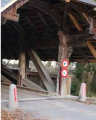
Brücke sorgfältig renoviert, aber die Poller lassen jede Sensibilität vermissen.
